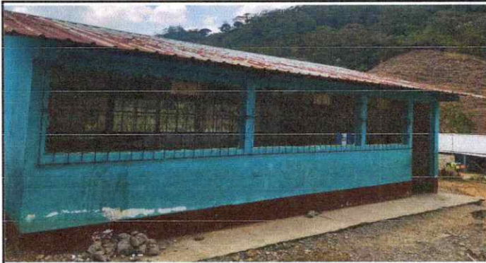
Foto 3: Aula 3: Cubierta de lámina con corrosión, puerta, balcones, sin canales y bajadas de agua pluvial, y con necesidad de pintura en el exterior e interior.
