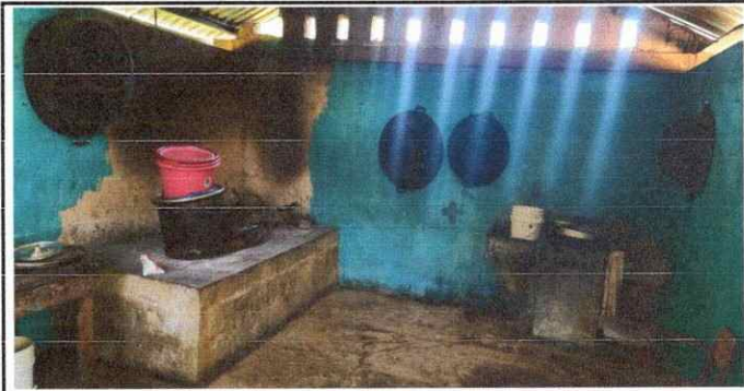
Foto 6: Cocina: Estufa a mejorar y pila.
