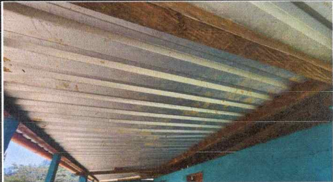
Foto 4: Cocina: Láminas dañadas y estructura de madera.
