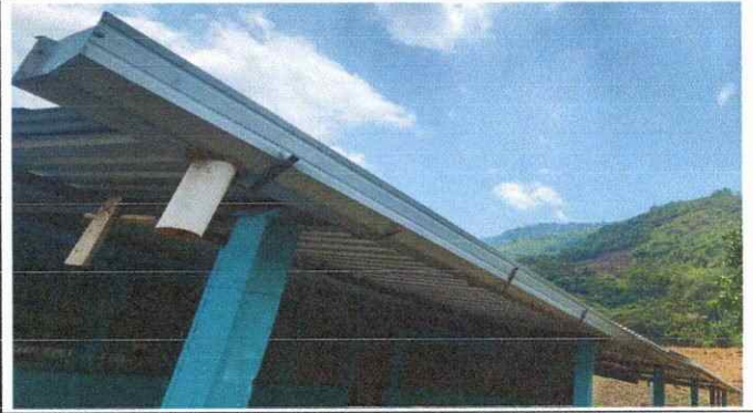
Foto 2: Módulo 1: Canales y bajadas de agua pluvial en mal estado.
