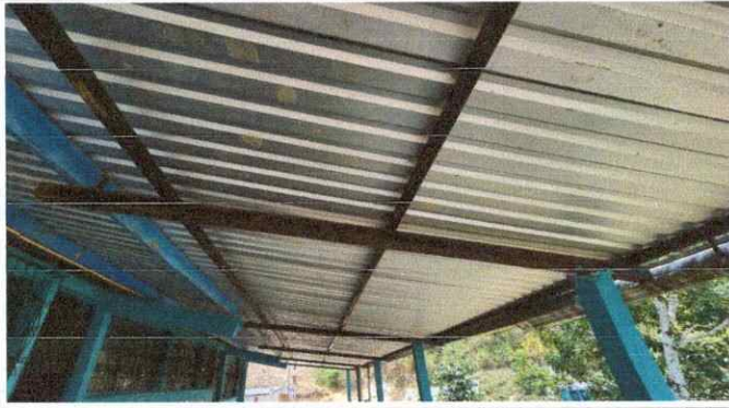
Foto1: Módulo 1: Estructura de techo y balcones con corrosión.
